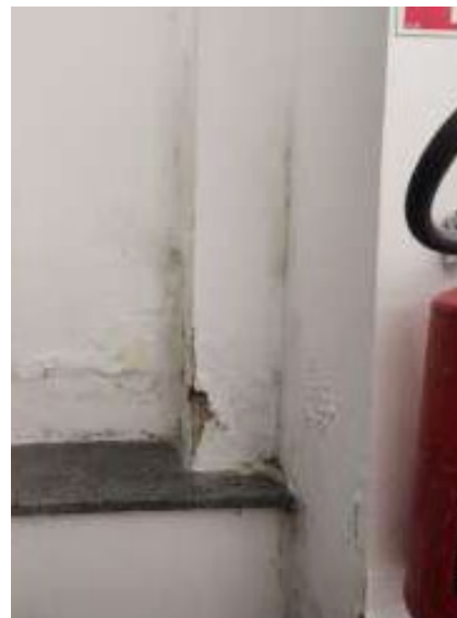
Foto 1. 11 Nível 2º Pavimento Local: Arquivo
